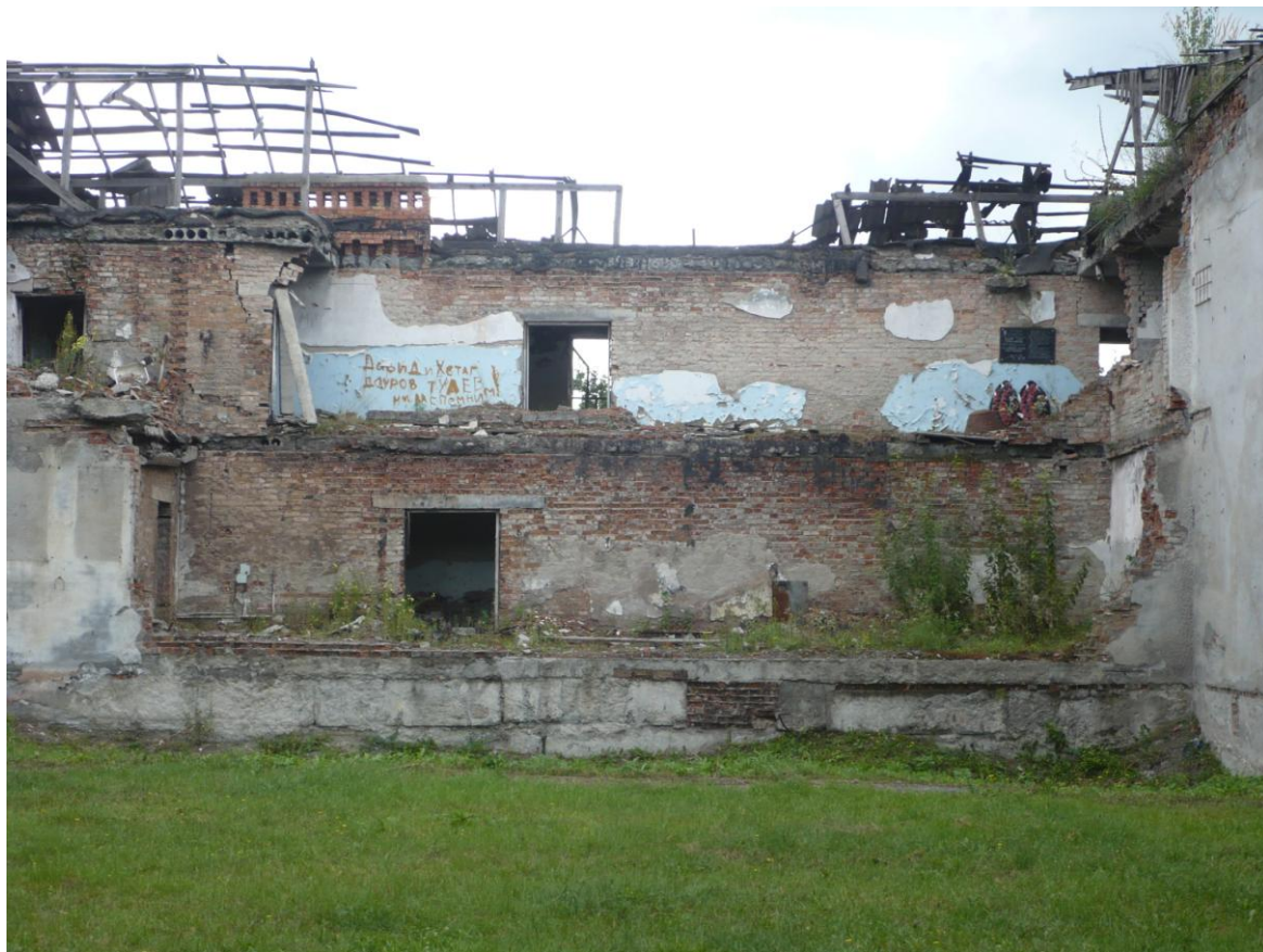
Рис. 40. Разрушения, якобы вызванные «накладным» взрывом, применённым для уничтожения террористов, скрывающихся в «подвале».
