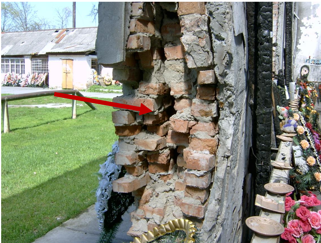
Рис. 75 д. Разрыв кирпичной кладки.
