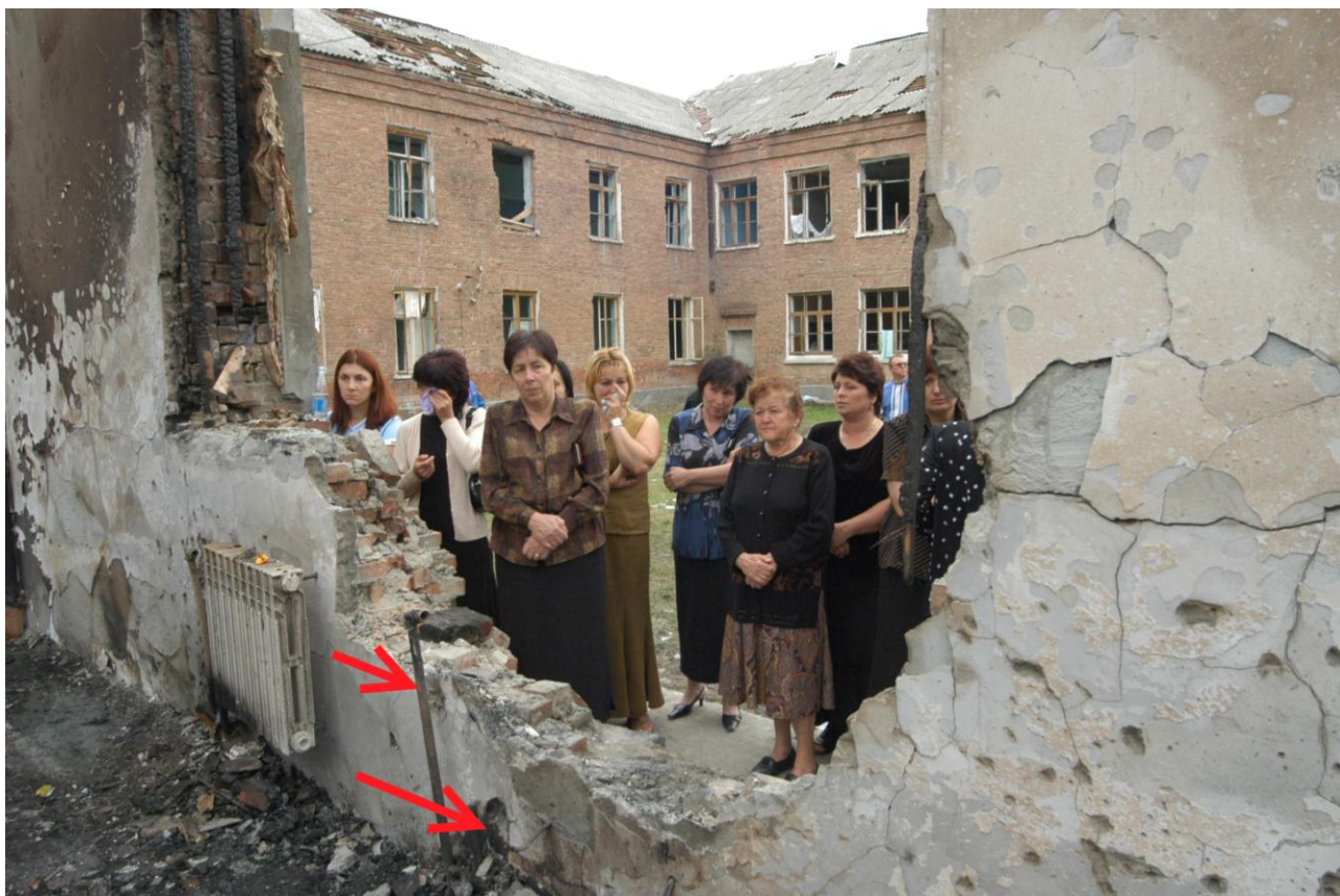
Рис. 75 а. Пролом в стене спортивного зала под окном. Стрелками указаны питающая труба и скоба, на которой висела батарея.
