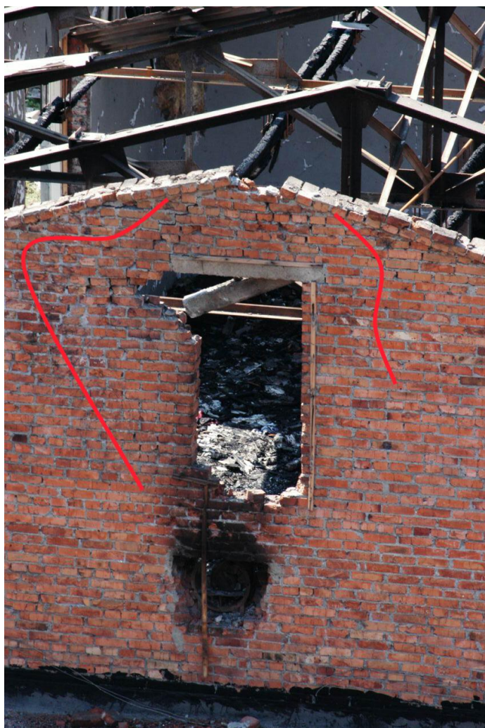
Рис. 80. Разрушение фронтона чердака.
