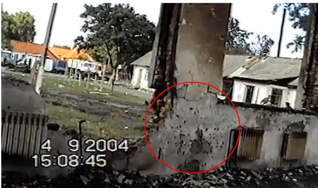
Рис. 75 б. Пролом в стене спортивного зала под окном. Локализация осколков.
