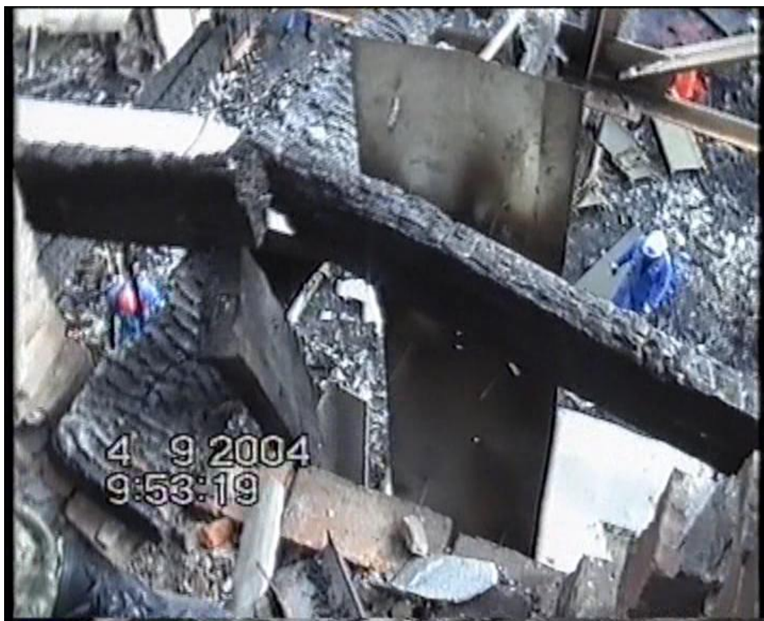
Рис. 21. Осмотр места происшествия. Крыша над классом осетинского языка.
